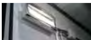
Sistema de iluminación interno
